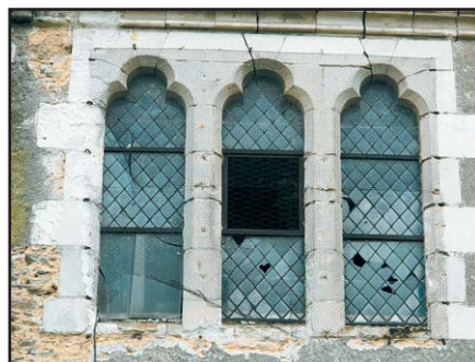
Certaines églises délabrées doivent être fermées pour des raisons de sécurité. CM
